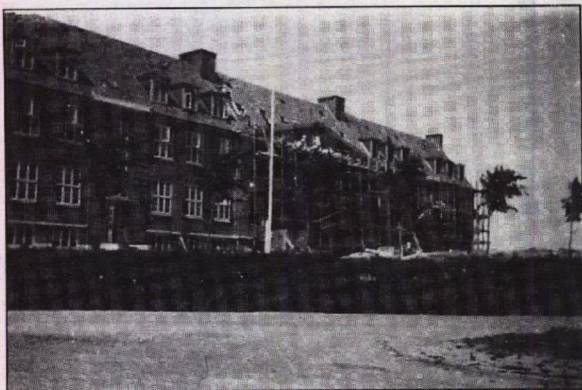
2' den etape af Hvidovre skole under afslutning, 1926. Frontispicen, hvortil skolens elever havde stået model, er under opførelse. Skoleudvidelsen, der blev taget i brug i 1926, fulgtes ti år senere op med opførelsen af en yderligere skole, og af endnu én et par år efter.
